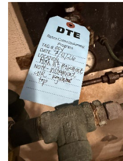
DTE Leak Tag
