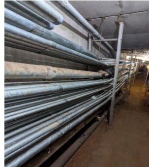
New electrical conduits in PS-1 Basement
