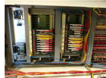
Lieb CSO, PLC Panel
