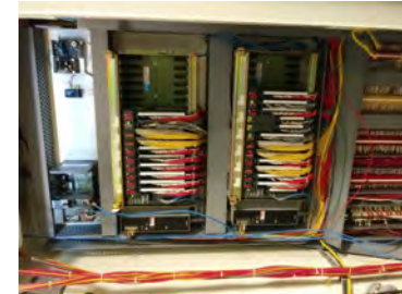
Lieb CSO, PLC Panel
